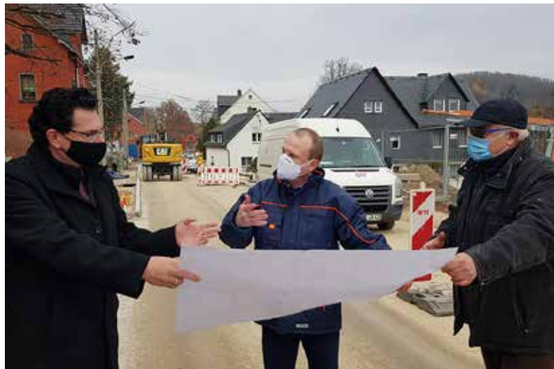
Ruben Gehart Oberbürgermeister von Schwarzenberg, Dr. Frank Kippig Geschäftsführer Wasserwerke West erzgebirge und Jörg Geller von der Baufirma WTI bei der Lagebesprechung kurz vor Fertigstellung der Baustelle.
