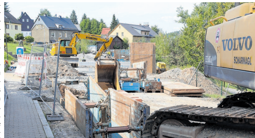
Aus einer Startgrube heraus wird mittels Bohrverfahren das Pilotrohr bis zur Zielgrube verlegt. In diesem wird danach das Medienrohr eingezogen.
