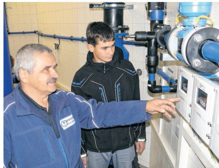
Mitarbeiter, der WASSERWERKE WESTERZGEBIRGE, Herr Andreas Gummelt (v.l.) erklärt hier dem Praktikanten Paul Kasper im Hochbehälter "Priester" warum Durchflussmengen gemessen werden und wie wichtig diese Werte im Zusammenhang für die Wasserwerke sind.
