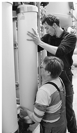
Einbau des letzten Ultrafiltrationsblocks in der 2. Aufbereitungsstufe
