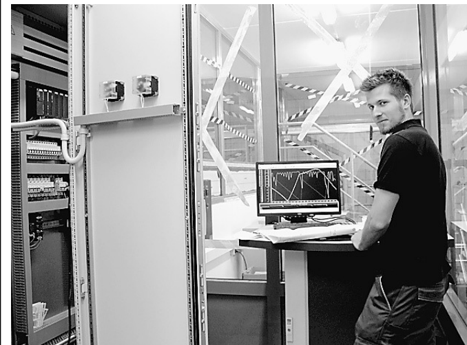
Installation des neuen Prozessleitsystems
